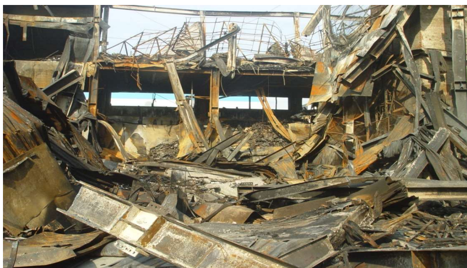
Фото 11 Вид объекта – здания складского назначения после пожара
