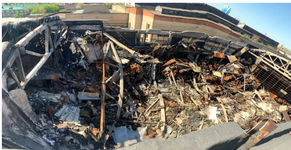
Фото 7 Вид объекта – здания складского назначения после пожара 30 июля 2021 г. огнём уничтожено четырехуровневое складское строение площадью 2000 м 2 , см. фото 8-11.
