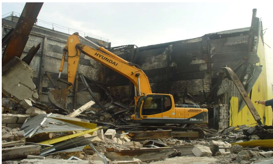
Фото 10 Вид объекта – здания складского назначения после пожара
