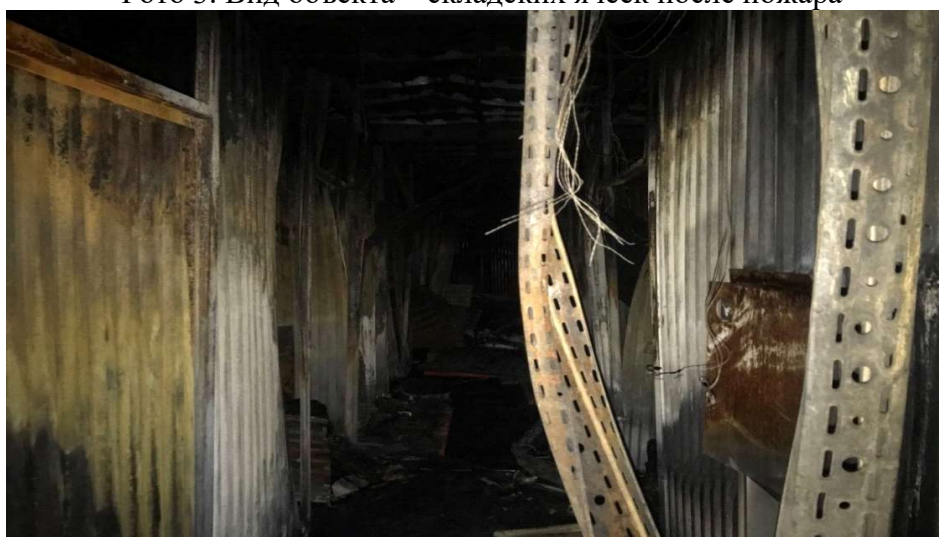
Фото 4. Вид объекта – складских ячеек после пожара
