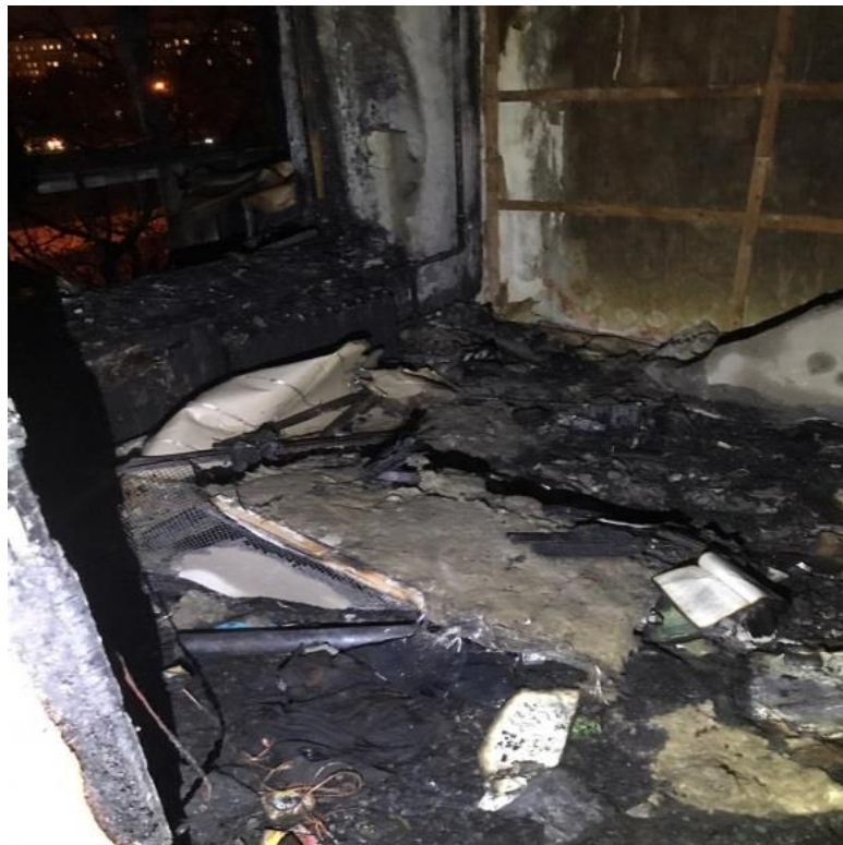
Фото 5. Общий вид термических повреждений комнаты. Красным овалом указано место обнаружения остатков трансформера.
