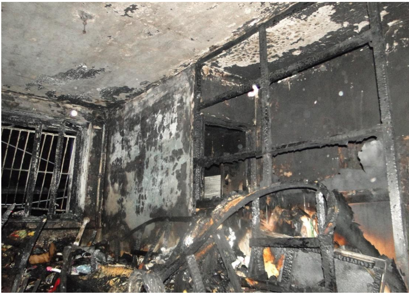
Фото 9. Термические повреждения квартиры, образовавшиеся после взрыва АКБ электросамоката.
