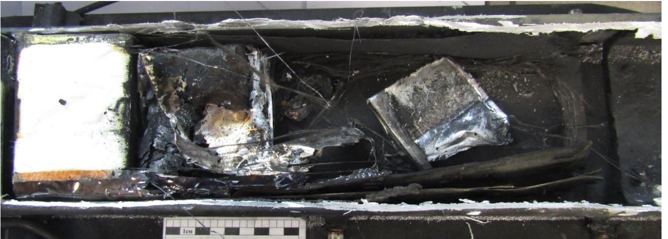
Фото 11. Крупный план поврежденных аккумуляторных батарей.
